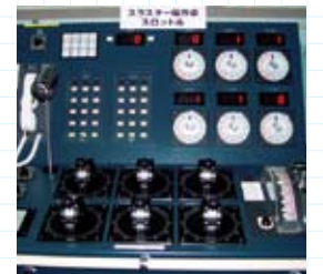
スラスト操作盤
