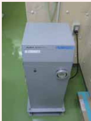
排ガス中の放射性物質濃度を 監視しているガスモニタ
