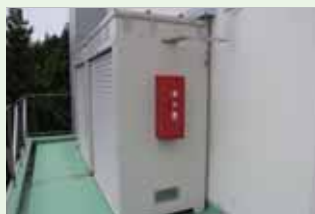
屋外に設置されたボンベ庫
