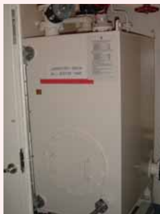
「ちきゅう」で発生した有害物質を含まない化学廃液をためておくケミカルバッファタンク。必要に応じて有害性の確認、pH 調整を行い、海洋中に放流する。
