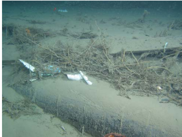
図3. ハイパードルフィンで観察された海洋深層水取水管の被災の様子
