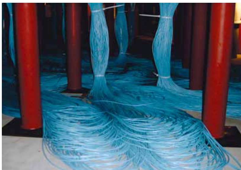
計算機フロアの床下(フリーアクセススペース)に敷設される膨大なネットワークケーブル。総本数8万3,200本、総延長約2,400kmに及ぶ。
