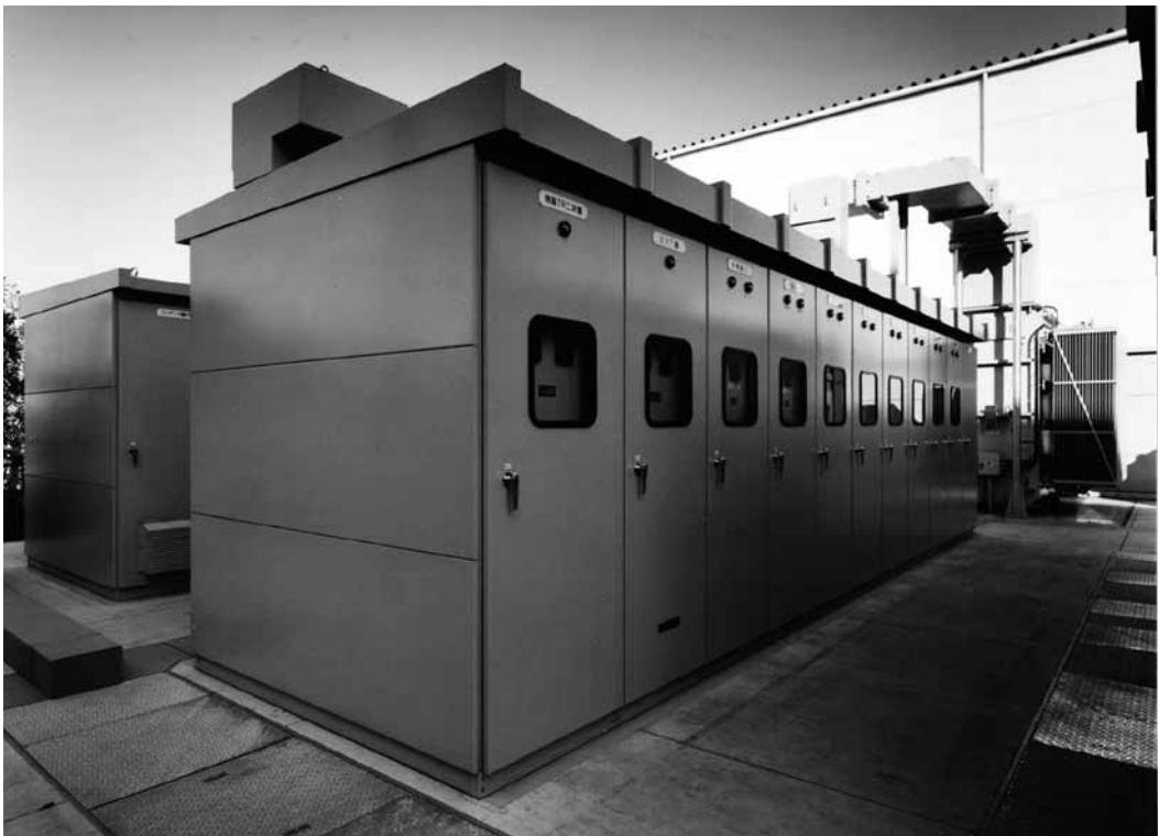
特高受変電設備 (66kV)
