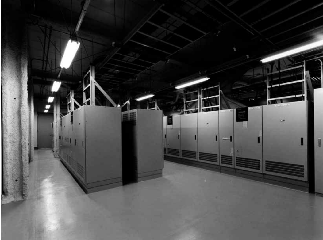
無停電電源設備 (UPS)
