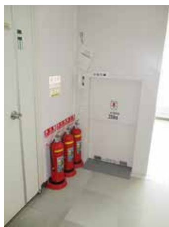
高圧ガス運搬用に専用の昇降機（エレベーター）を整備しました
