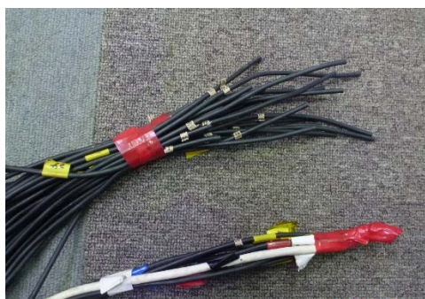
外部側ケーブル
