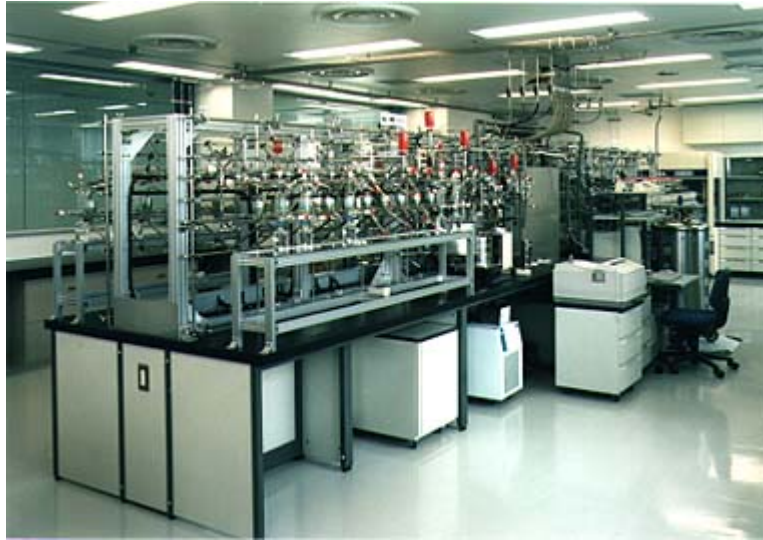
試料分析棟 試料前処理室に設置した海水試料前処理装置
