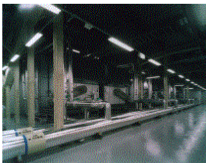
空調機械室 (14万㎡×24機)
