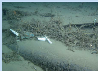
▲「ハイパードルフィン」で観察された海洋深層水取水管の被災の様子
