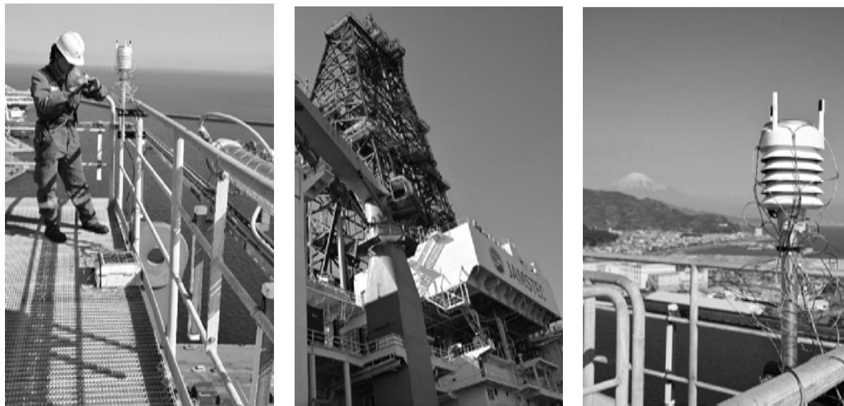
図 1. エレベーター最上階に設置した気象センサーの外観状況（2017 年 2 月 16 日～3 月 30 日の清水港停泊期間中）.
