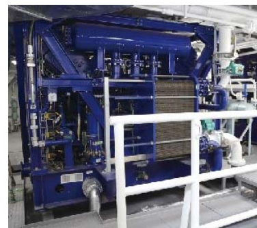
写真-2 KM 搭載エアガンコンプレッサー
